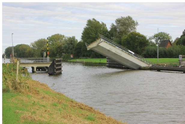
De PP-brug na de aanvaring / september 2018
